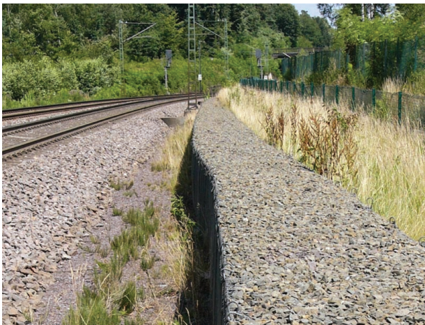
Gabionen ohne böschungssichernde Wirkung
